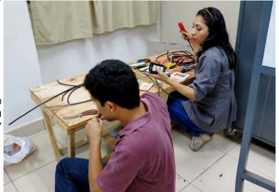
G) Instalación eléctrica lámpara UV
