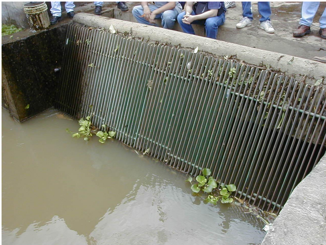
Obra de Toma en el dique anterior en que se observa la emulsión mencionada
