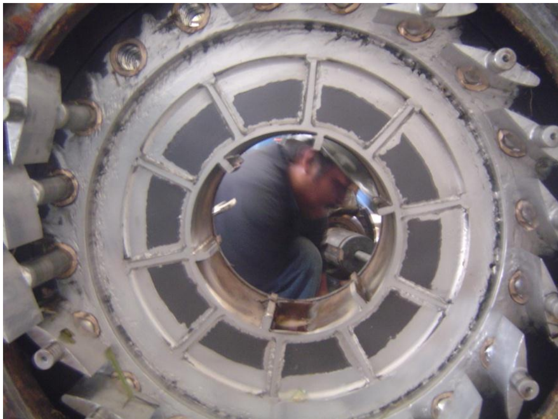
Desgastes en una tapadera de la turbina, la cual ha sido ya revestida con lámina Hardox antidesgaste.
