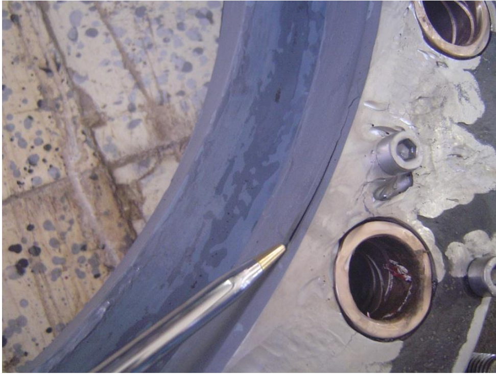
Desgastes en los manguitos y anillos de una tapadera
