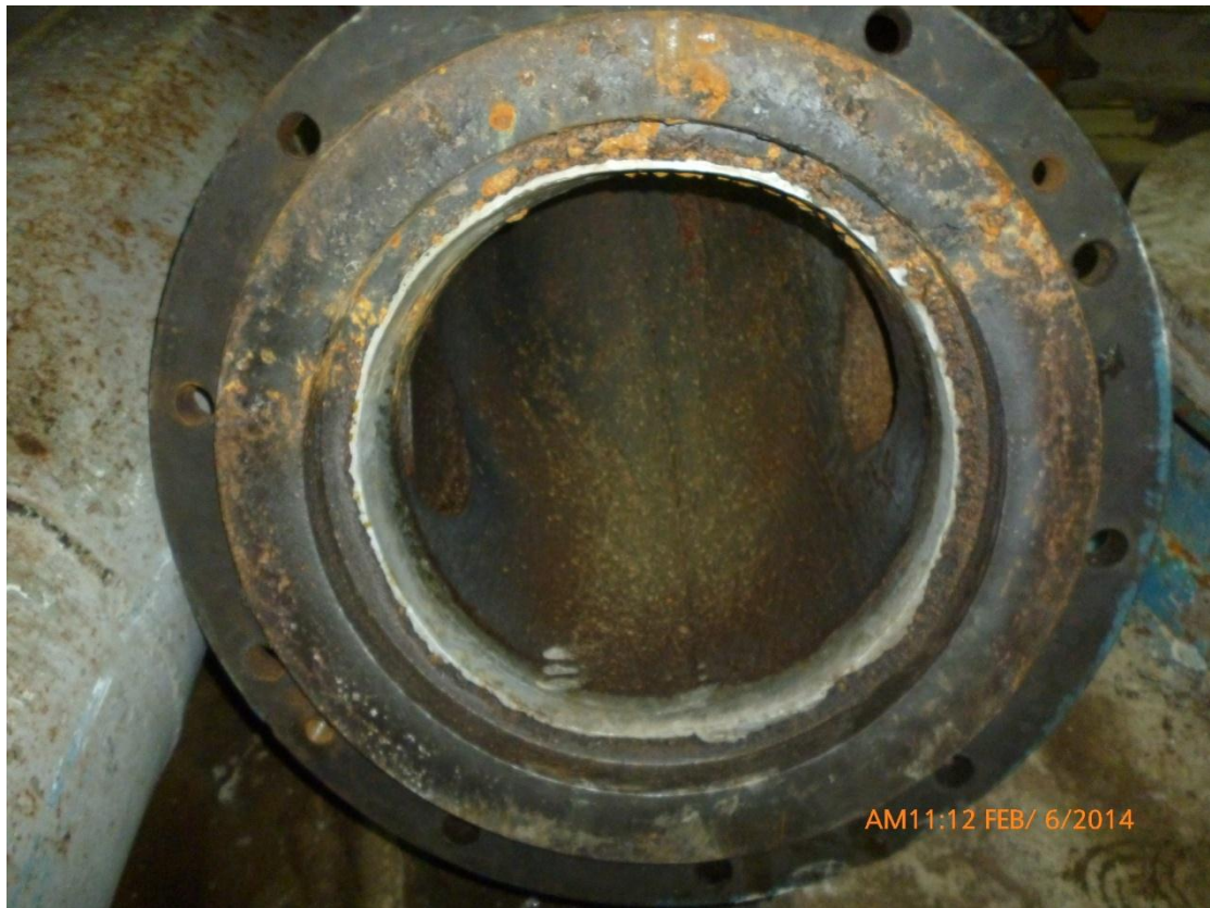
Esta fotografía muestra el codo de descarga de una turbina de la planta hidroeléctrica la Calera.
