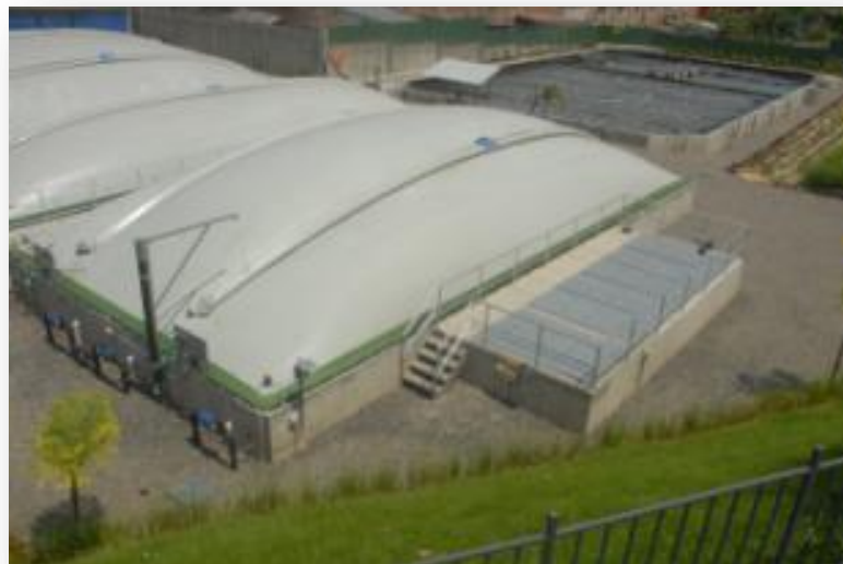
Planta de tratamiento de aguas residuales en Planta de Cerveza
