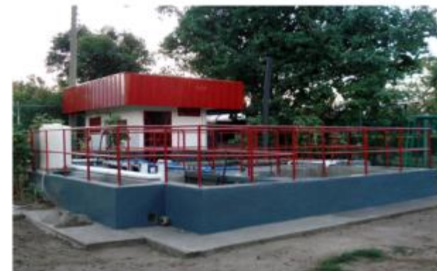
Planta de tratamiento aguas negras NIXAPA
