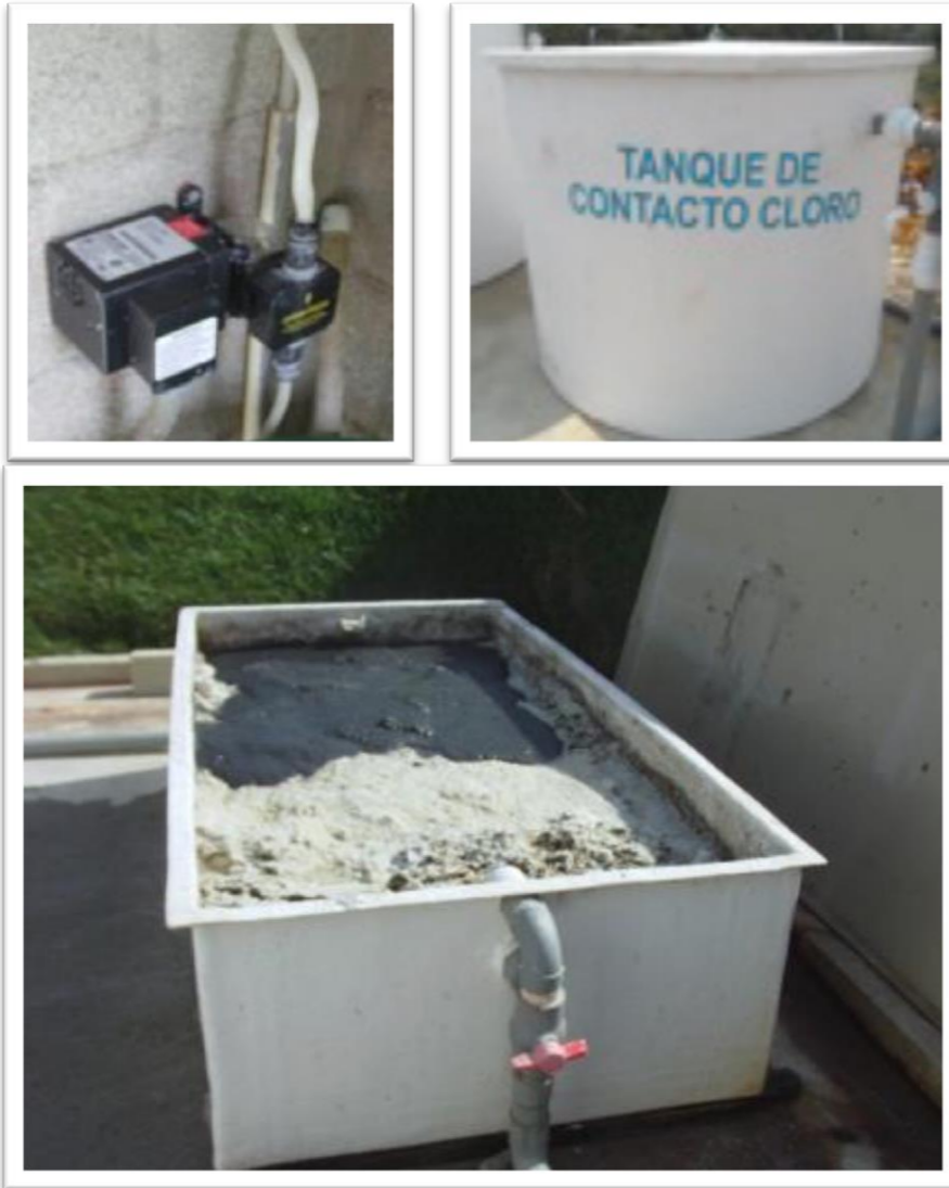
Fotografía 6: Tanque de Almacenamiento de lodos
