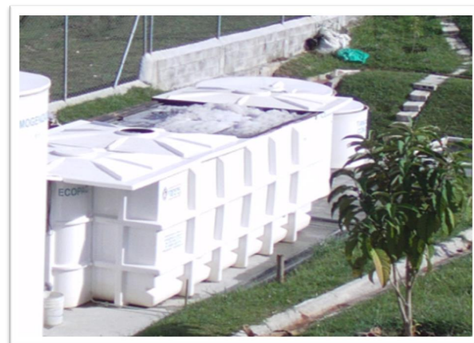
Fotografía 4: Reactor de lodos Activados
