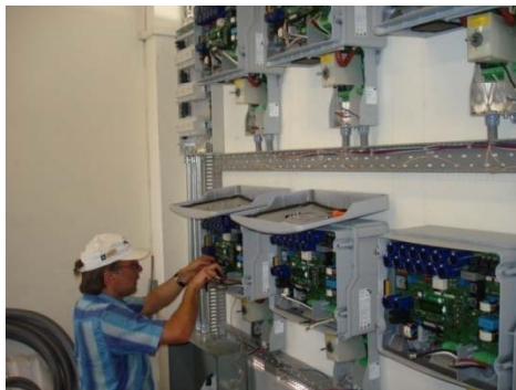
Conexión de cableado de inversores
